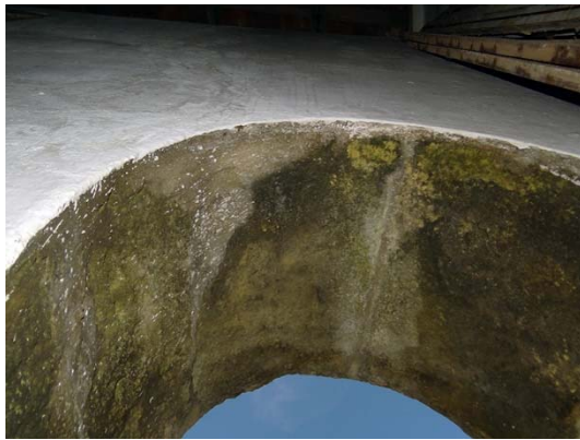
Figura 98 – O arco está com rejunte de cimento
