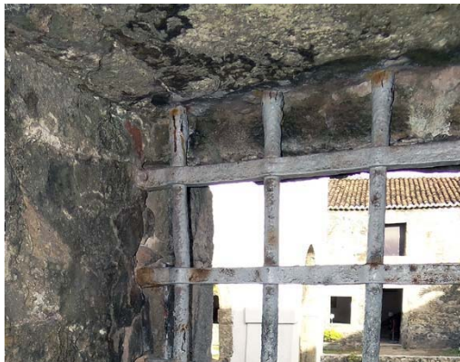
Figura 86 - O vão da janela foi quebrado para colocar uma grade.
