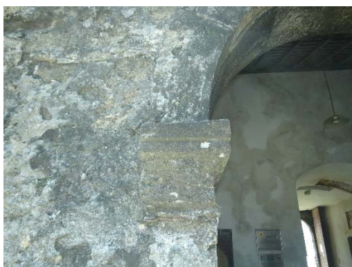
Figura 199 - Intrusão de telha coberta por argamassa e granito na ombreira direita.
