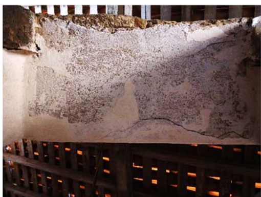
Figura 302 - Verga está coberta ou substituída por cimento.
