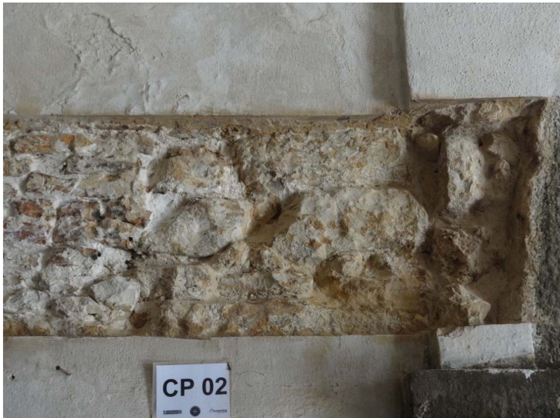
Figura 348 - Detalhes do corte CP 02, onde se pode observar a alteração da argamassa que consolida a parede de pedras, na área da remoção. No limite do local em que as pedras foram removidas para a supressão de parte da parede, pedras menores foram assentadas para regularizar a superfície. Neste trabalho ficou ressaltada a diferença das argamassas utilizadas nos dois momentos.
