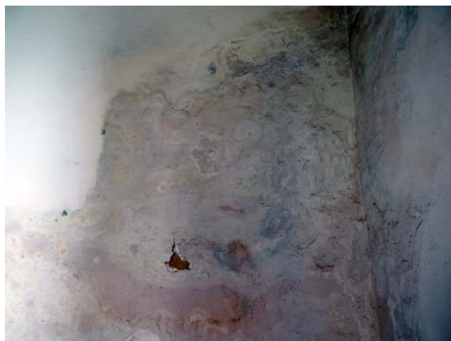
Figura 316 - Re boco com infiltração de umidade.
