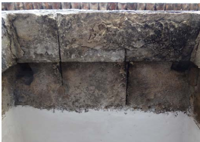
Figura 422 - Detalhe das marcas de engaste da porta
