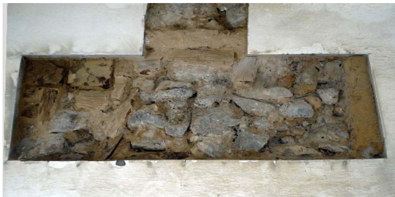
Figura 448 - Lo cal onde deveria haver as aberturas para ventilação no interior da casamata.
