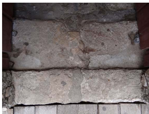
Figura 258 - Soleira remendada com cimento.
