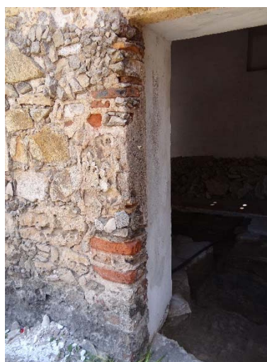
Figura 250 - Construída em alvenaria, pode ter sido aberta recentemente.
