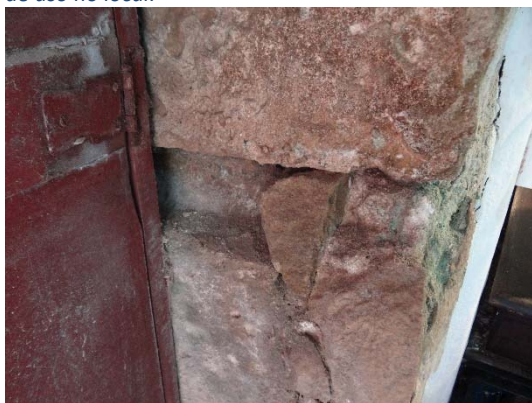
Figura 271 - Marca de canaleta nas ombreiras.
