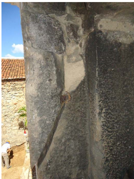
Figura 235 - Ombreira direta danificada por rachadura.
