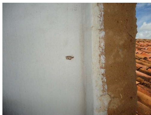
Figura 184 - Marca de ferrolho na parede.
