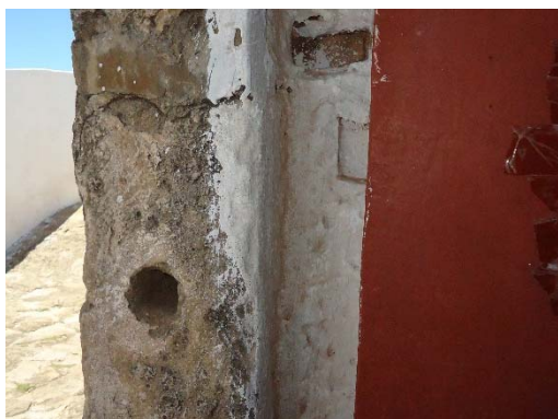
Figura 278 - Marca de trava na ombreira direita.
