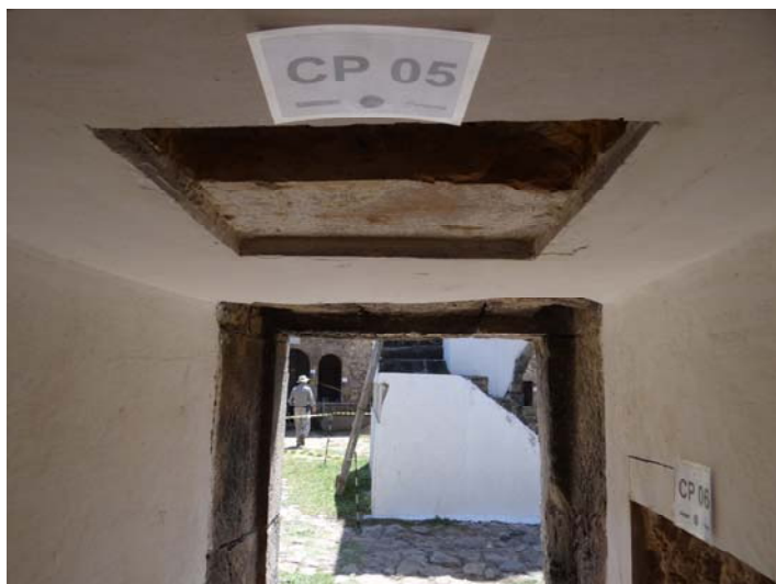
Figura 419 - Corte no teto plano que revelou a presença de uma estrutura de arco em tijolos que primitivamente constituía a abóbada da poterna.
