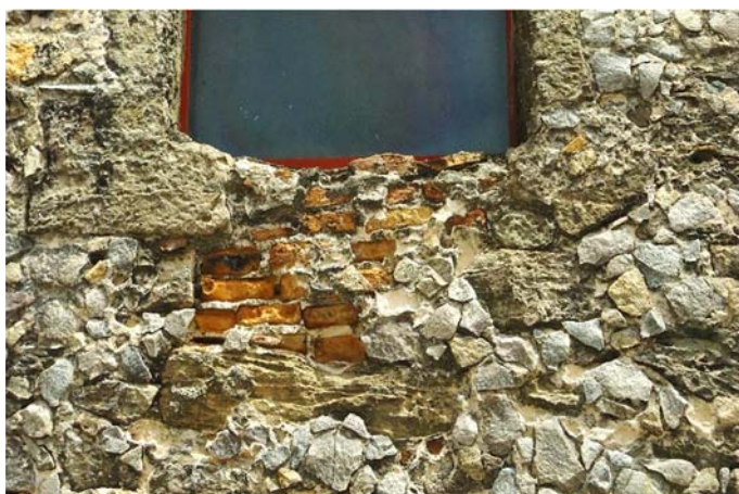
Figura 136 - Estrutura retangular fechada com tijolos, que removeu parte do peitoril.
