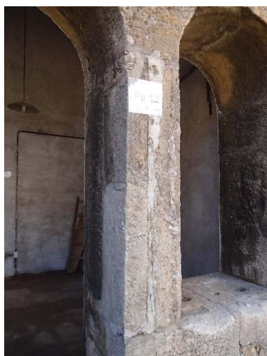
Figura 238 - Rejunte de cimento sugerindo recolocação de duas peças em cantaria
