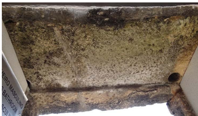
Figura 219 - Rachadura e marca de eixo na verga.
