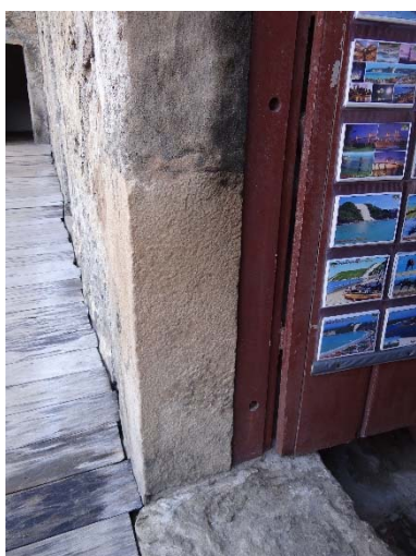
Figura 264 - A ombreira direita está parcialmente substituída
