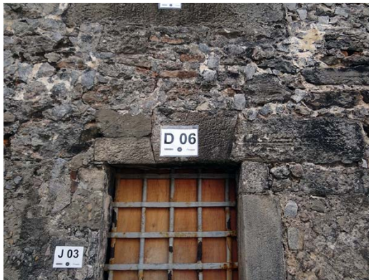
Figura 84 - A verga está danificada e parte dela foi substituída.
