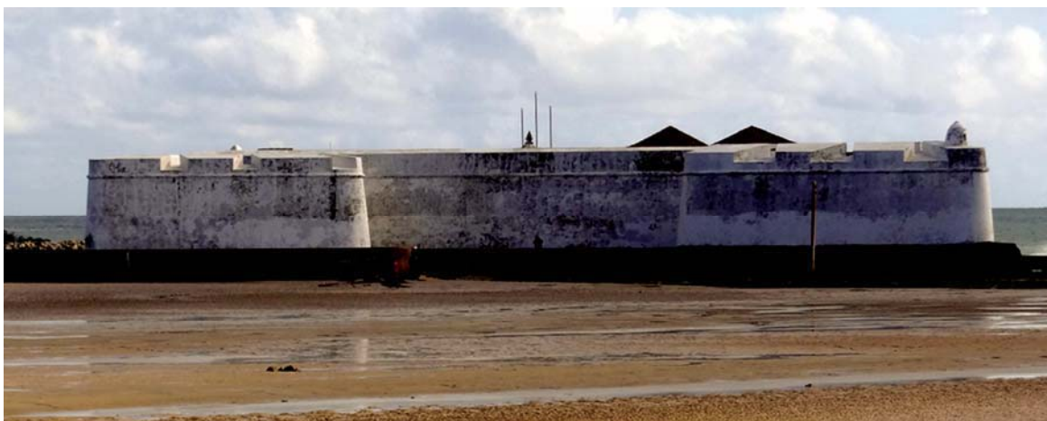
Figura 482 - Observe-se a inclinação da muralha.
