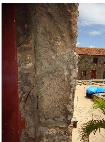
Figura 167 - Rachadura com adição de cimento na ombreira esquerda.
