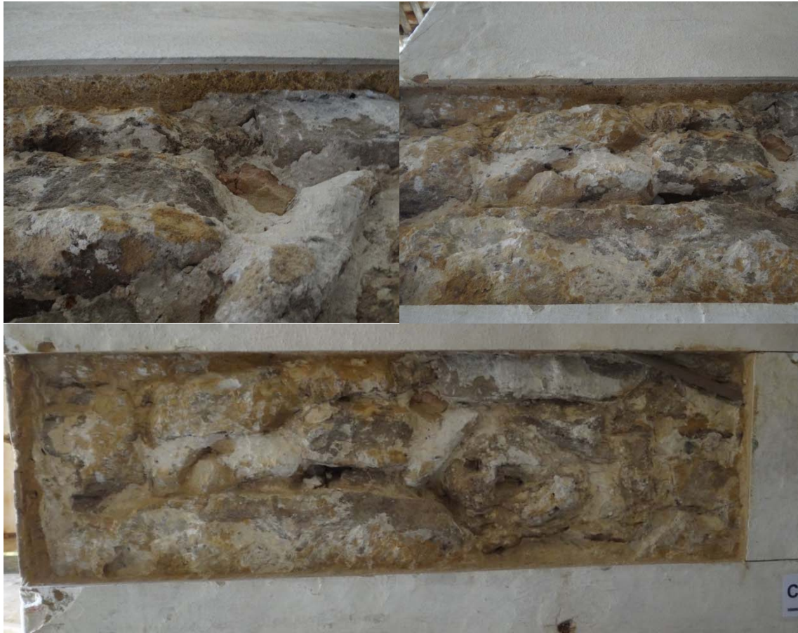
Figura 347 - Detalhes do corte CP 01, onde se pode observar a alteração da argamassa que consolida a parede de pedras, na área da remoção.
