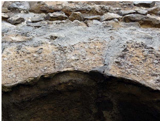
Figura 101 – O arco está com rejunte de cimento
