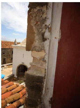
Figura 183 - Ombreira desgastada e faltando peças.
