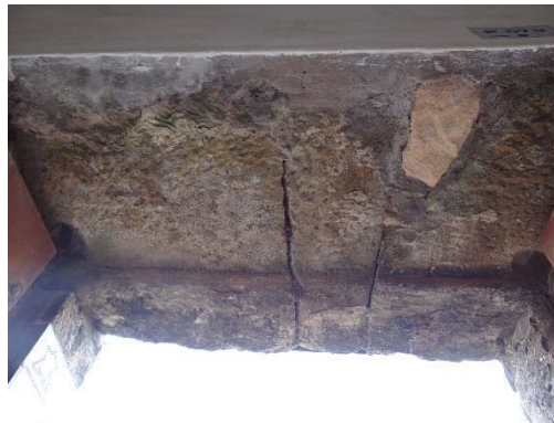
Figura 207 - A verga possui pedra de centro e está remendada.
