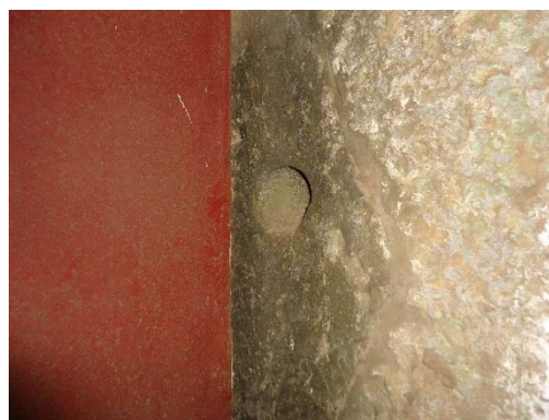
Figura 164 - Marca de tramela na ombreira direita.
