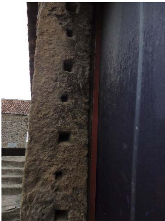
Figura 151 - Marca de grade na ombreira direita.
