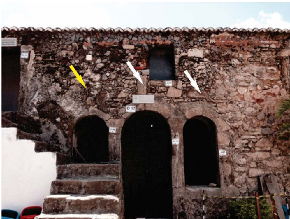
Figura 374 - As setas brancas apontam as pedras que serviriam de suporte ao alpendre, hoje cortadas de modo a se nivelar com a parede; a seta amarela o local onde teria existido a terceira pedra, removida, deixando na parede a marca da remoção.
