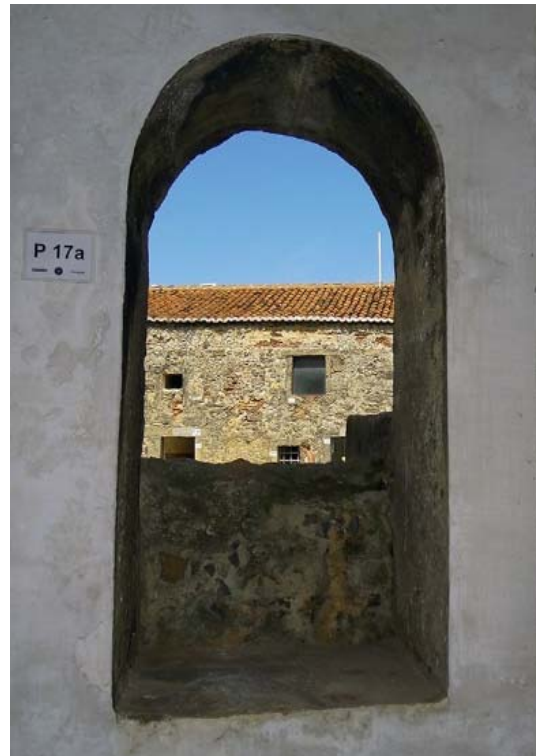
Figura 99 - A janela está parcialmente fechada pela escada da cisterna.
