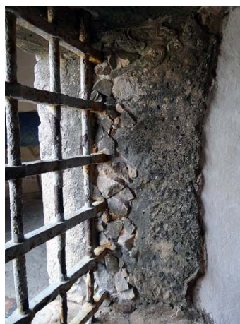
Figura 78 - O vão da janela foi quebrado para colocar uma grade.
