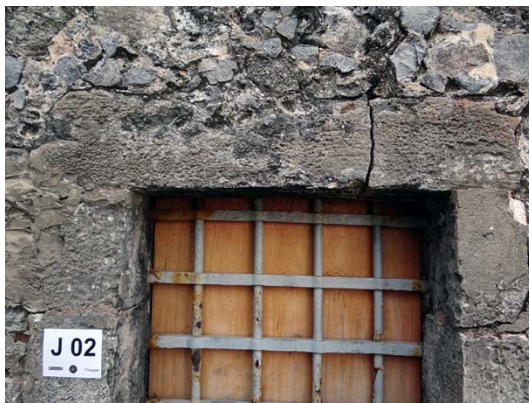
Figura 81 – A verga está quebrada.
