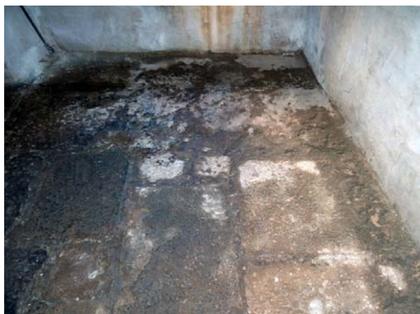
Figura 436 - Lajes de arenito apresentando desgaste acentuado próximo à canhoneira.
