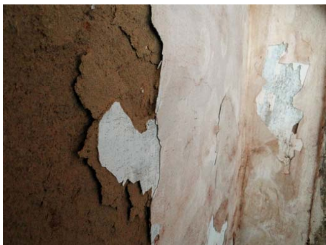
Figura 317 - Re boco deteriorado, escamando.
