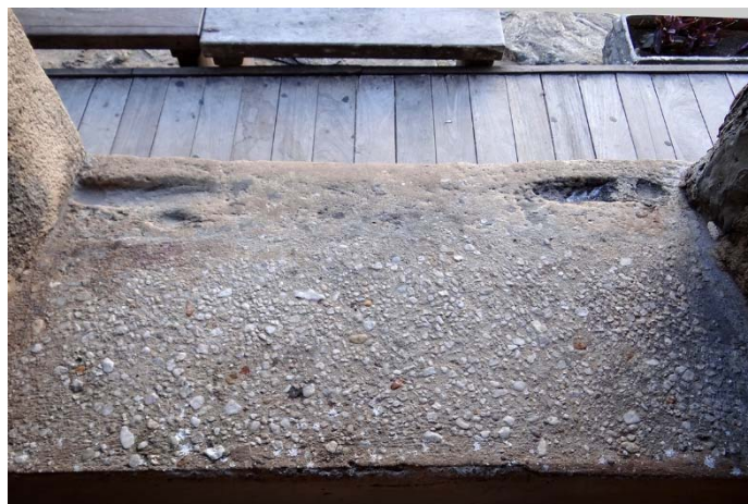
Figura 123 - O peitoril foi reconstruído parcialmente com seixo e cimento. No trecho de pedra em cantaria vemos marcas das janelas.
