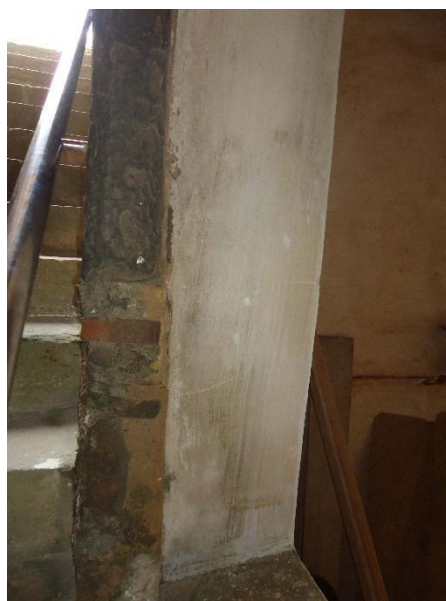
Figura 303 - As ombreiras estão parcialmente rebocadas.
