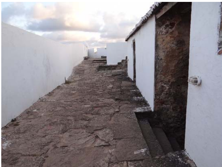
Figura 484 - Observe-se o desnível no terrapleno entre área próxima à escada e o baluarde de São Tiago.
