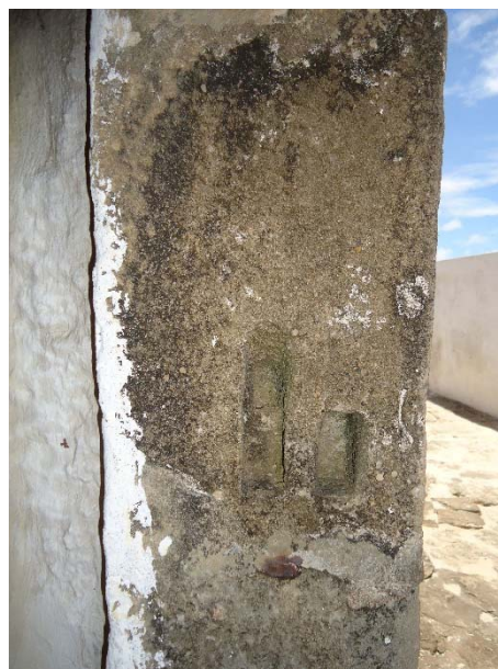
Figura 277 - Marca de fechadura e trava na ombreira esquerda.
