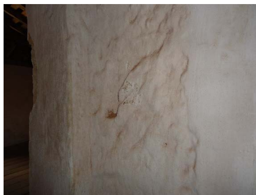
Figura 314 - Marca de tramela sob o reboco.
