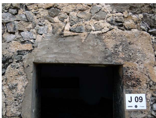
Figura 109 - A verga está quebrada, reconstruída em cimento.
