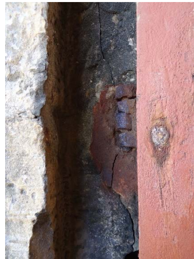
Figura 195 - Rachadura na ombreira direita a partir da dobradiça.
