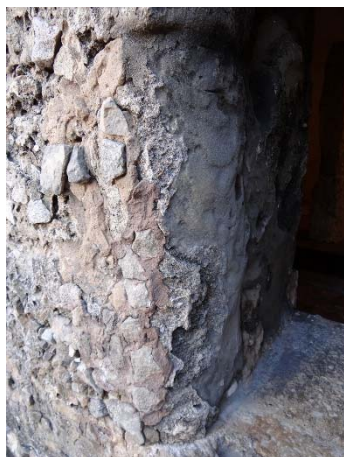
Figura 121 - A ombreira direita está recoberta parcialmente por cimento e granito.
