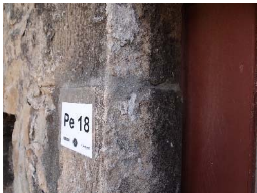
Figura 260 - Rejunte em cimento na ombreira esquerda.
