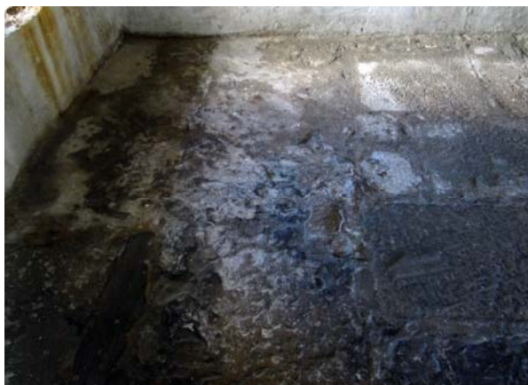
Figura 437 - Detalhe da erosão do piso.
