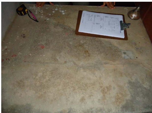
Figura 161 – Peitoril em arenito coberto com cimento.
