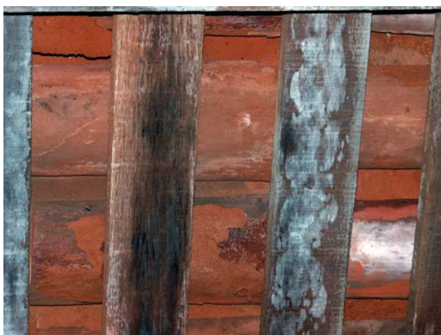
Figura 318 - sobre as ripas de 10 cm de largura, telhas escamando.
