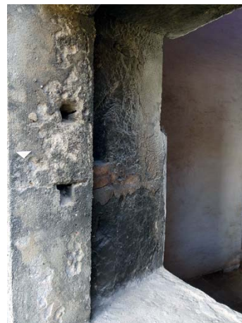
Figura 106 - Na cercadura há marcas de grade reconstruídas em cimento.
